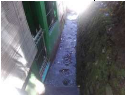
Gambar 4.4 Kondisi Jalan Lingkungan
