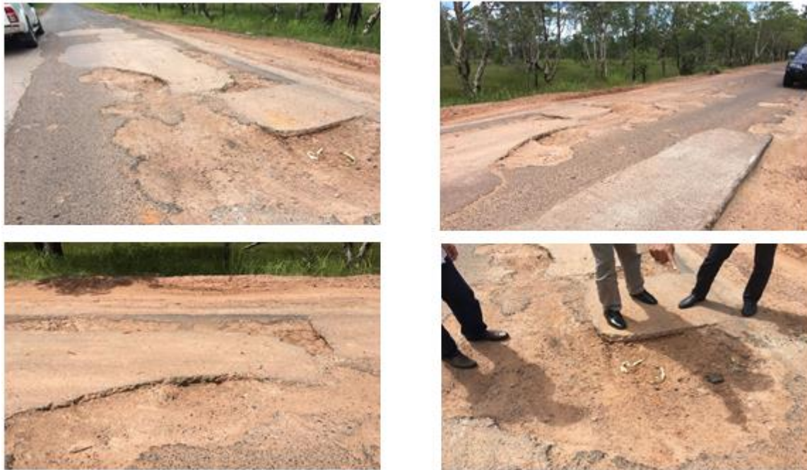
Gambar 1. Contoh kerusakan jalan di lokasi penelitian dengan penanganan yang kurang tepat
